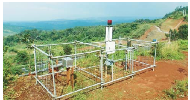
写真4 移設された監視装置
